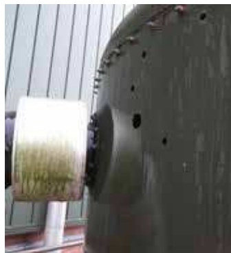
Poškodenie cez celú hrúbku steny
